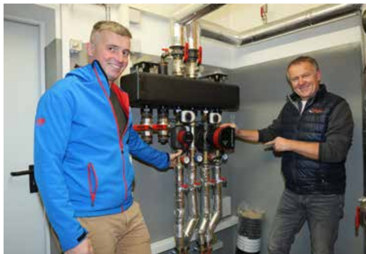
Werner Schragl zeigt bei der Verteilerstation im Heizraum auf „seine“ Leitung, die Wärme zu seinem rund 30 Meter entfernten Haus liefert. Er schätzt es sehr, dass er kein Heizöl mehr bestellen muss und die Wertschöpfung in der Region bleibt.
