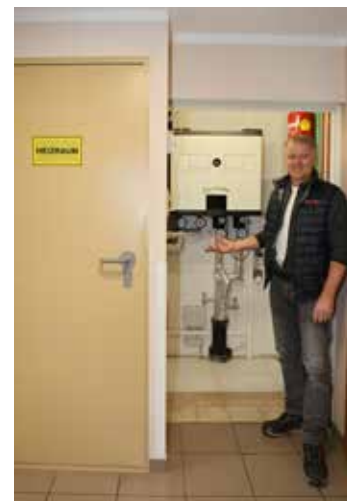
Neben dem Abgang zum seinem ehemaligen Heizraum präsentiert Werner Schragl die Wärmeabnahmestation im Haus.
